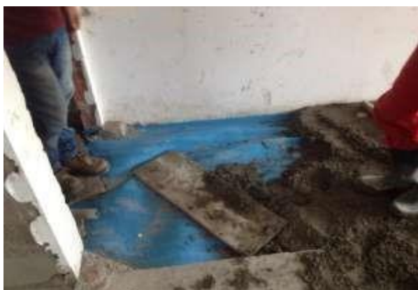
Figura 1: Virada de rodapé não realizada.
