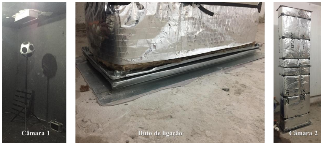
Figura 5: Câmara 1, duto de ligação e câmara 2.
