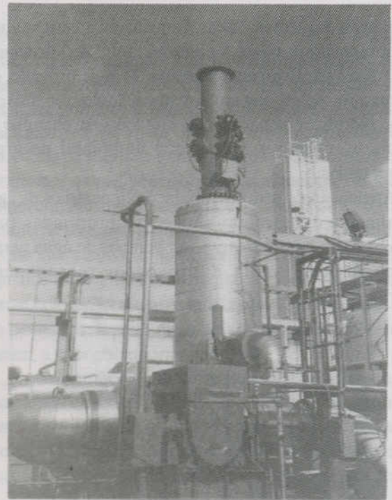
Fig. 4. Duto com controle ativo conectado a uma chaminé de exaustão de uma turbina de geração de energia (cortesia da Digisonix)
