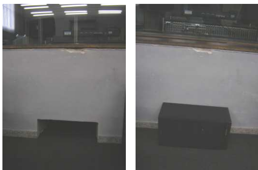
Figura 7: Buraco para passagens de cabos e uso da caixa de som como medida provisória para fechá-lo
