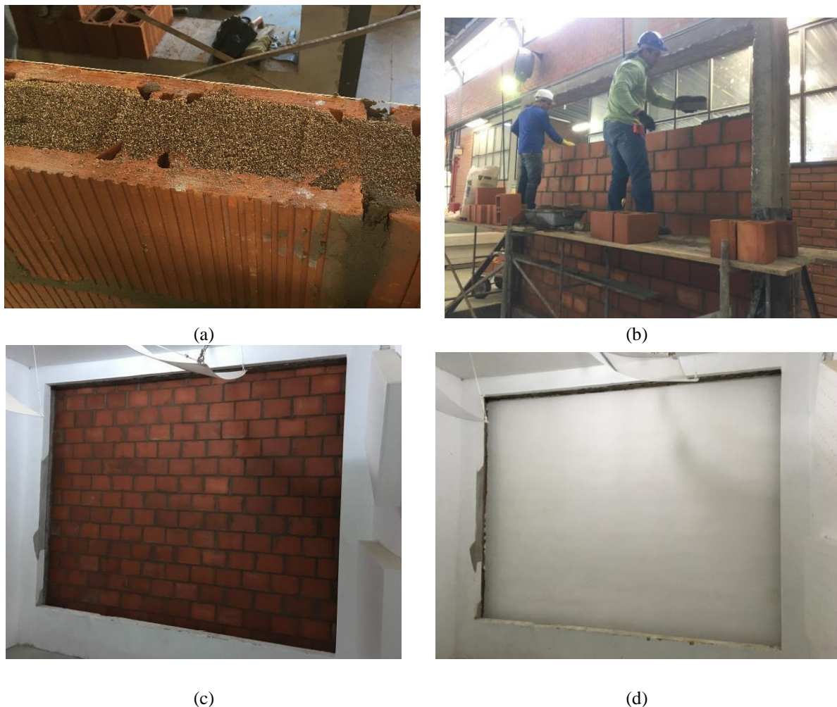
Figura 2: Etapas de construção das amostras: (a) preenchimento dos blocos com vermiculita, (b) construção das alvenarias fora da câmara, (c) amostra sem revestimento instalada na câmara, (d) amostra com revestimento instalada na câmara.
