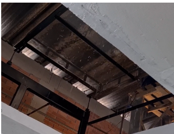
Figura 5: Vista interna do Reservatório 1 com a placa perfurada.
